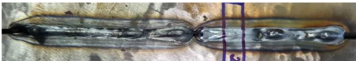
Figura 59 - Soldas realizadas na sobrecabeça com escorrimento. Fonte: O autor.
