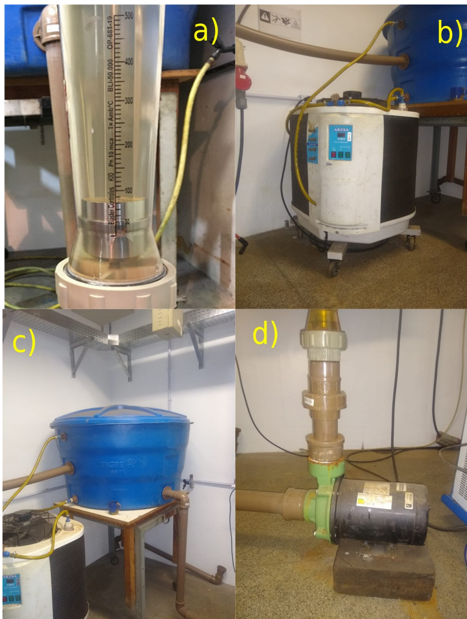
Figura 26 - Componentes do circuito hidráulico com exceção do tubo. a) Rotâmetro b)Chiller c) Reservatório d) Bomba de 1 cv.
