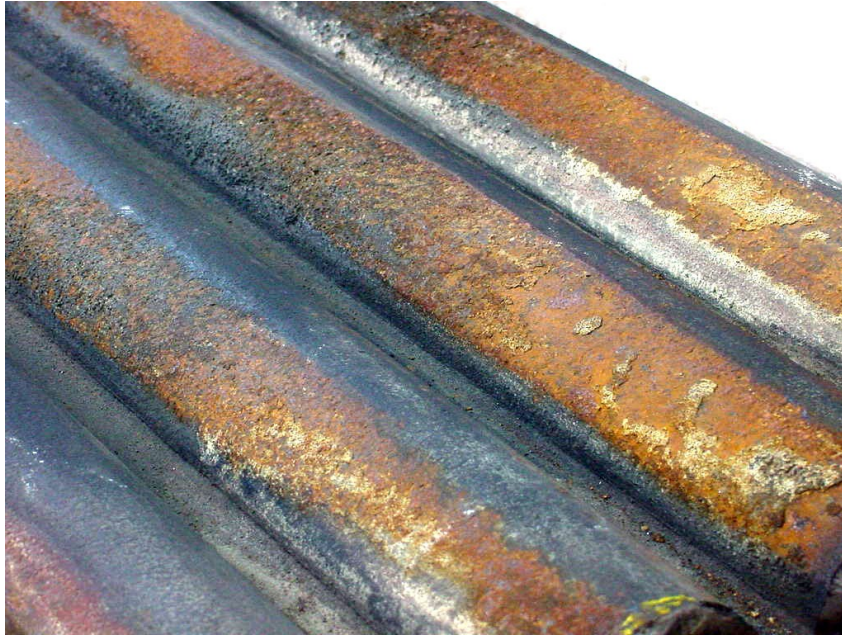
Figura 1-2 – Região afetada por erosão e corrosão (4)
