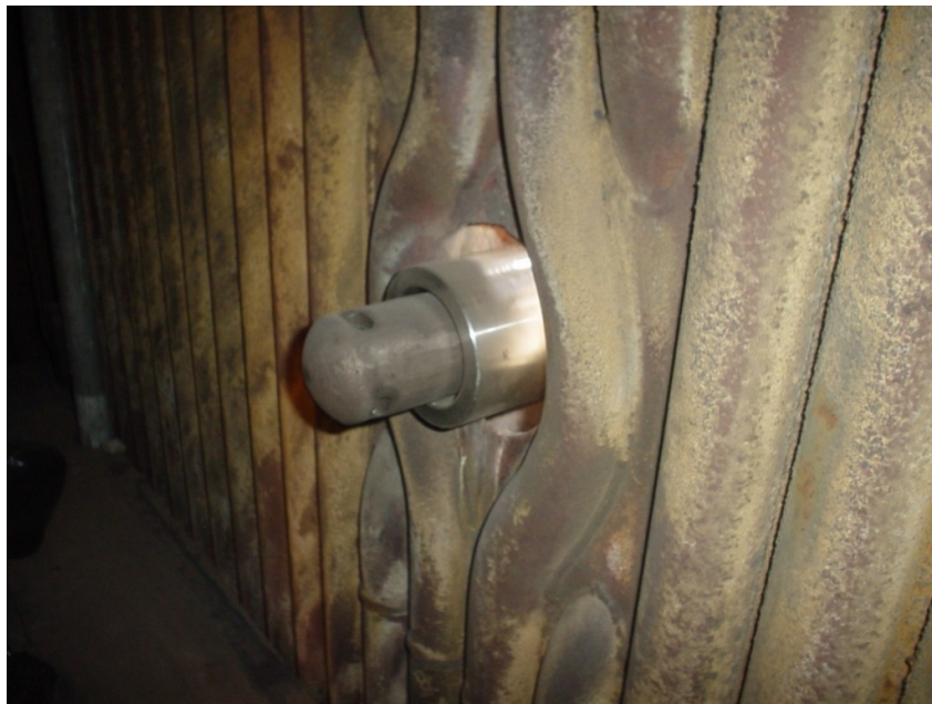
Figura 1-3 – Soprador de vapor (4)
