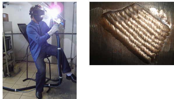
Figura 25. Revestimento manual realizado por técnico da Tractebel Energia, com um dia de treinamento
