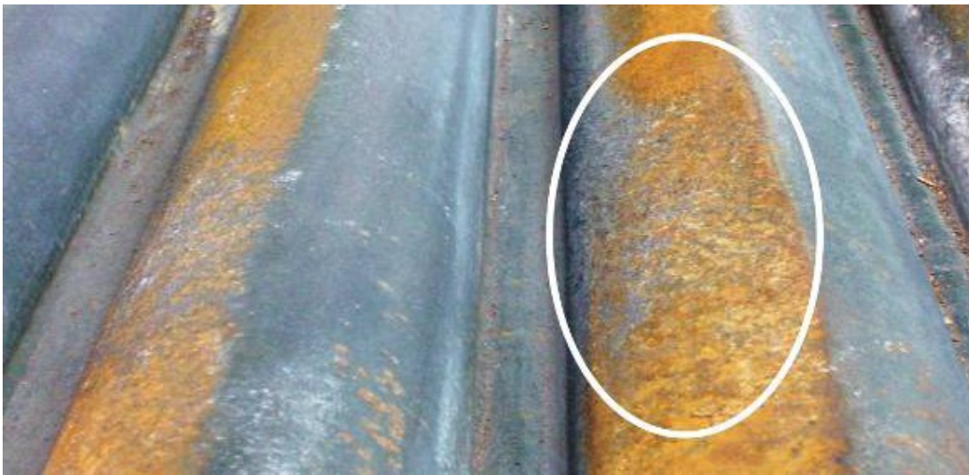
Figura 1. Região afetada por erosão e corrosão.
