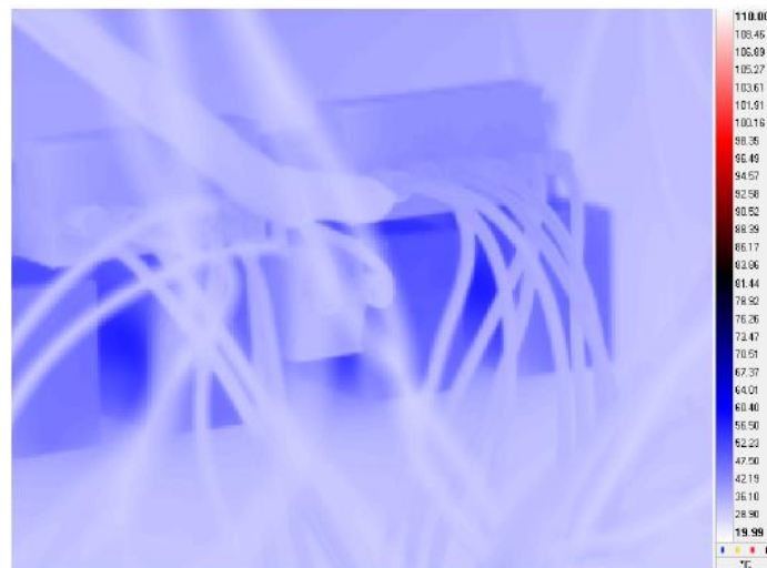
Figura 6 – Terminais de contato após a manutenção (Termograma)
