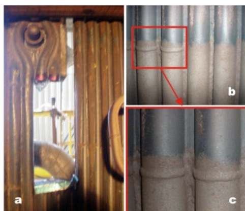
Figura 1. Processo manual de recuperação, em (a) corte da parede e em (b) e (c) soldagem TIG de união.
